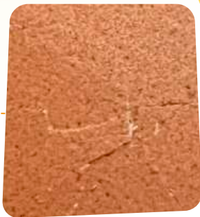
Foto 12. Fisura tipo estrella.
