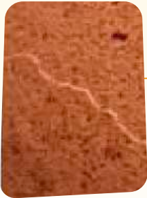
Foto 11. Fisura tipo cabello.
